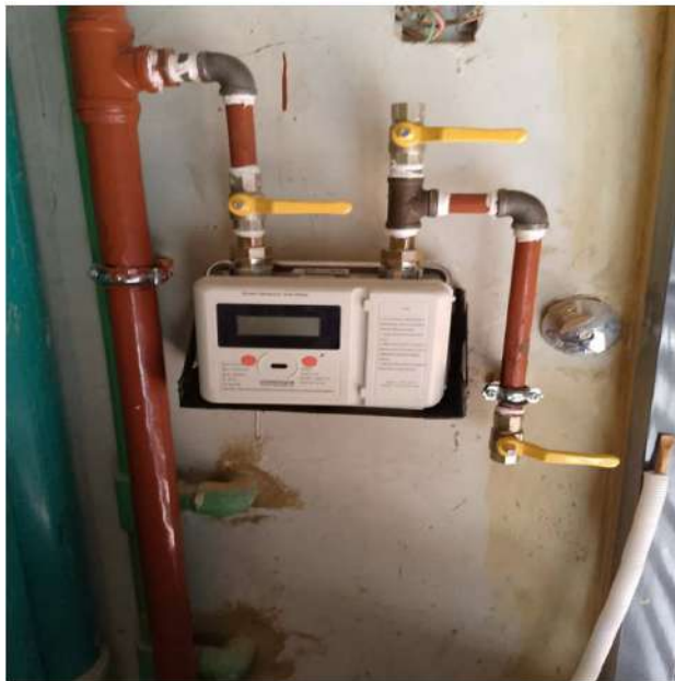
Otentique Gas Meter
